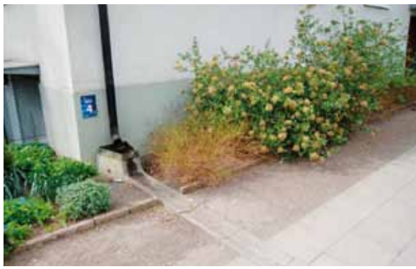
OBR. 49: Záchyt a odvod dažďovej vody ZDROJ: archív autora, Ing. Zuzana Hudeková
